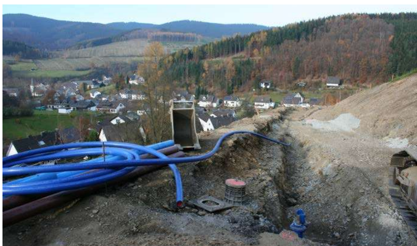
2011 wurden im zweiten Bauabschnitt des Baugebietes Oberer Taasberg die Leitungen für die Hauptwasserleitung verlegt (Foto). Bereits 2002 wurden diese im ersten Bauabschnitt verlegt.
